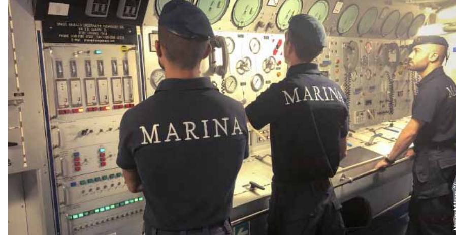
OSSERVATI SPECIALI. La sala controllo dell'impianto iperbarico. Sotto, la campana per le immersioni.
